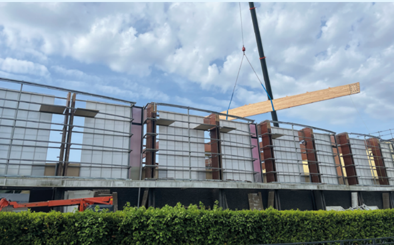
➤ Opération de levage des poutres de la charpente de la salle Majau
